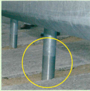
ガードレール支柱地際部
